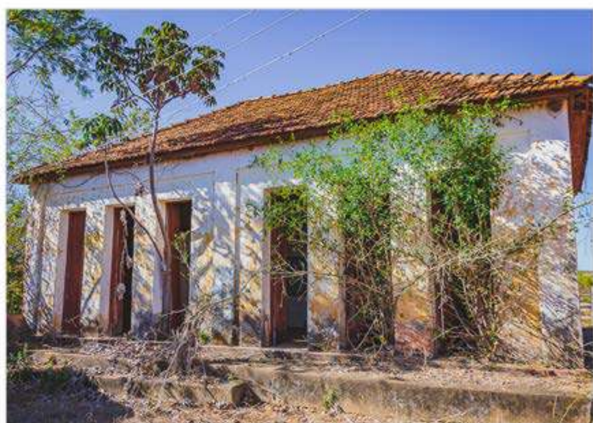
Construção em ruínas
