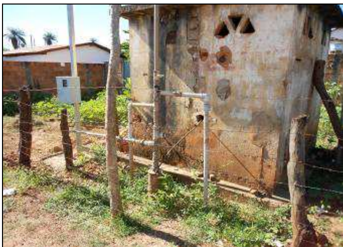
Foto 05 – Vista do poço tubular E-01 em funcionamento.
