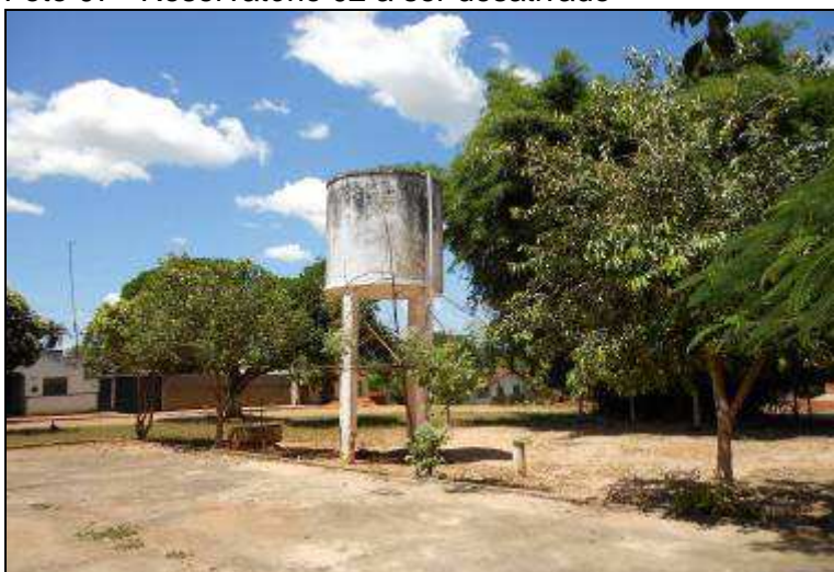
Foto 08 – Reservatório 03, a ser desativado
