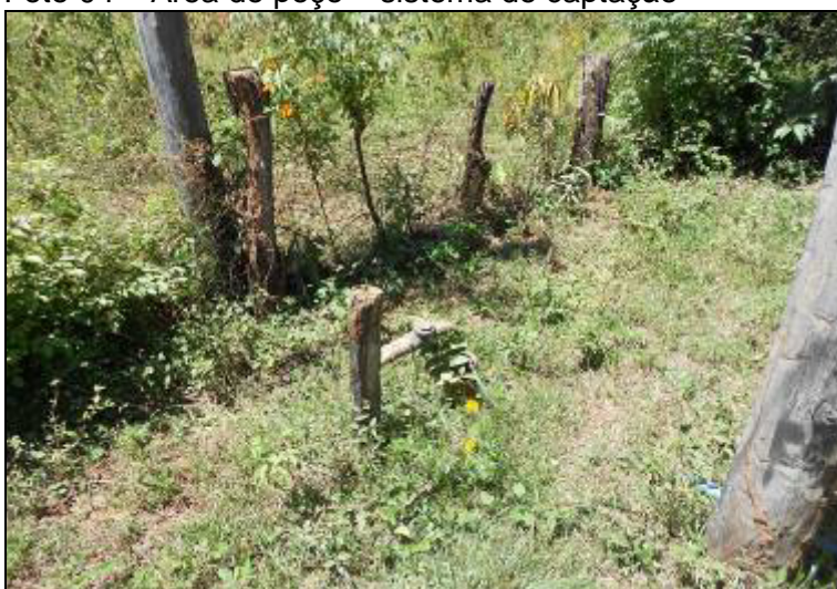
Foto 05 – Vista do barrilete do poço tubular – 2”
