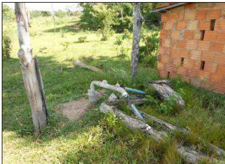
Foto 05 – Vista do poço tubular em funcionamento
