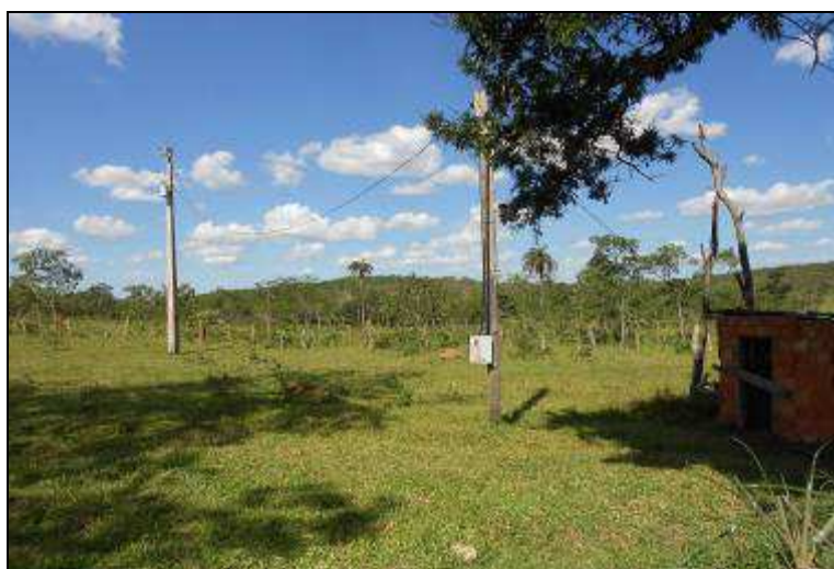
Foto 06 – Posteamto de energia elétrica na área do poço.
